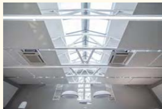
Umbau im laufenden Betrieb: ohne Arbeitsunterbrechung konnte die Raumakustik in den Büros optimal verbessert werden. Die Elemente fügen sich perfekt in die bestehende Raumoptik ein ohne den Lichteinfall zu behindern.
