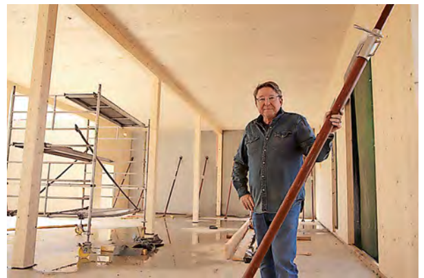
Investor Carsten R. Kulbe ist stolz auf das Projekt: fast vier Meter hohe Räume mit Wänden aus Südtiroler Fichte und offen in den Räumen angebrachter Technik.
