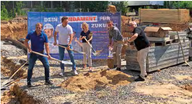
Den Erweiterungsbau entworfen hat Architekt Matthias Hetterich (Hetterich Architekten Würzburg), der ebenso wie Jochen Göbel als Mitinhaber der ausführenden Firmengruppe Göbel zum Spaten griff.
